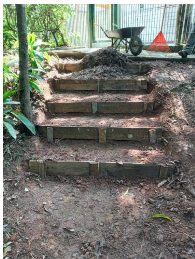
Figura 7: Melhorias das trilhas do parque Lajeado com a reforma e colocação de triturado
